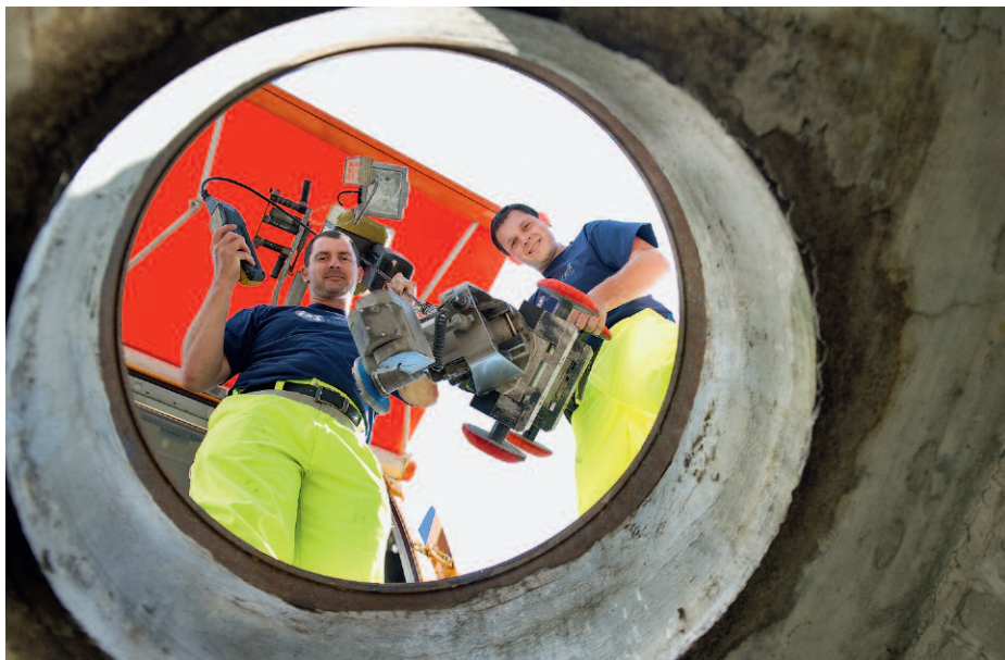
Ab in den Untergrund: Unvorhergesehene Schäden können mit regelmässiger Kontrolle und Wartung vermieden werden.
